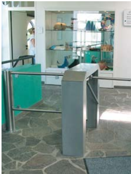
Eine automatische Schwenktür neben der Dreh- sperre sorgt für den barrierefreien Zugang
