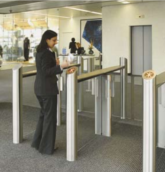
Ausweisleser stilvoll im Leitelement integriert/ Anlage mit Holzhandlauf
